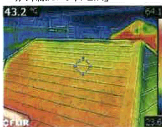
▲遮熱塗料を塗布後に赤外線カメラで撮影、温度がどれだけ下がったのかを画像で示している
